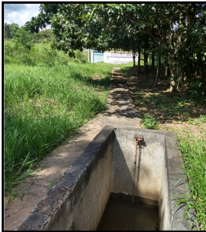
Foto 6.1.5 – Poço de sucção
