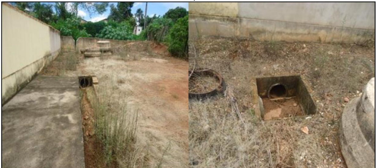
Foto 8.1.5 – Falta de proteção em vala de drenagem e em boca de lobo (Rua Maria José Faria)
