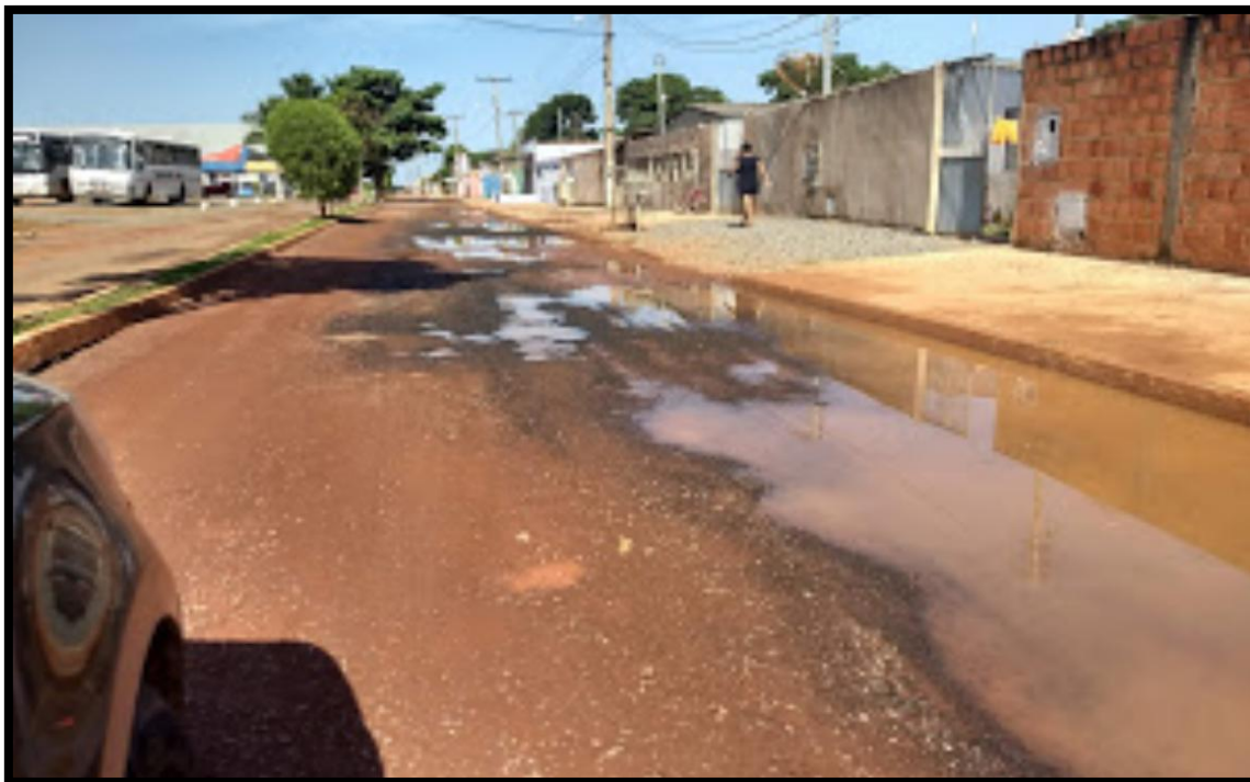
Foto 7.2.4 – Infiltração do nível d'água em rua pavimentada (Não é água de chuva)
