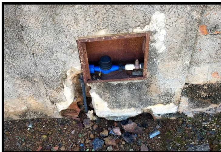
Foto 6.2.7 – Hidrômetro instalado em Domiciano Ribeiro
