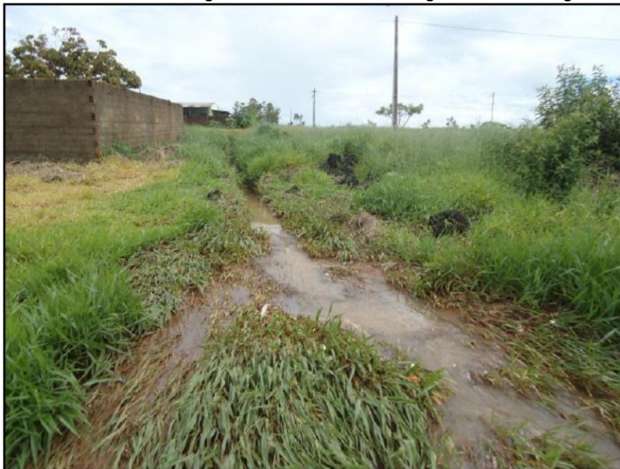
Foto 8.2.3 – Desague do sistema de drenagem em lote vago
