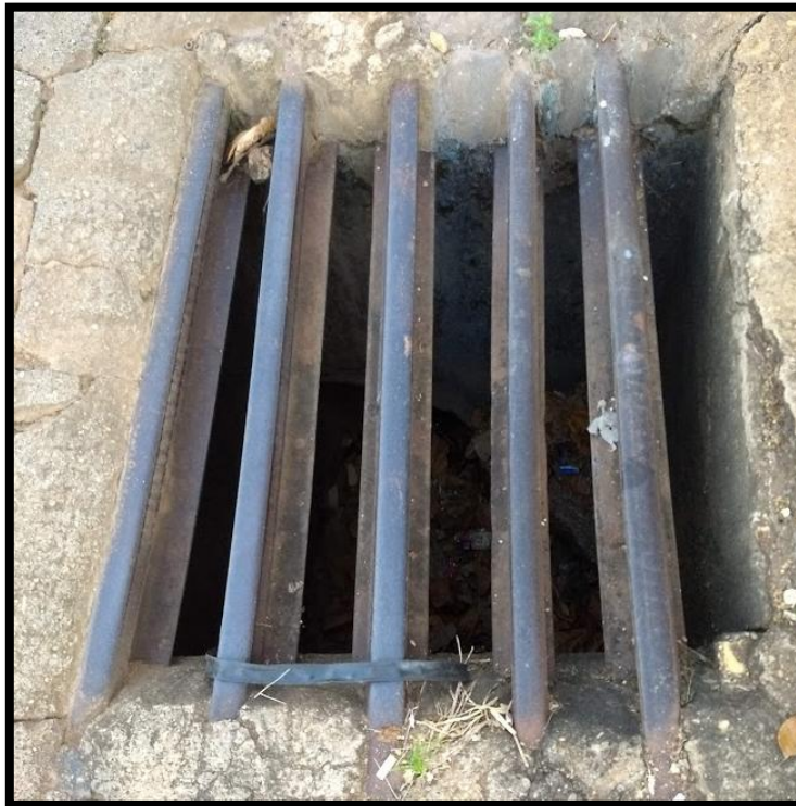
Foto 8.1.4 – Boca de lobo – Av Marechal Costa e Silva com R. Irineu de Souza
