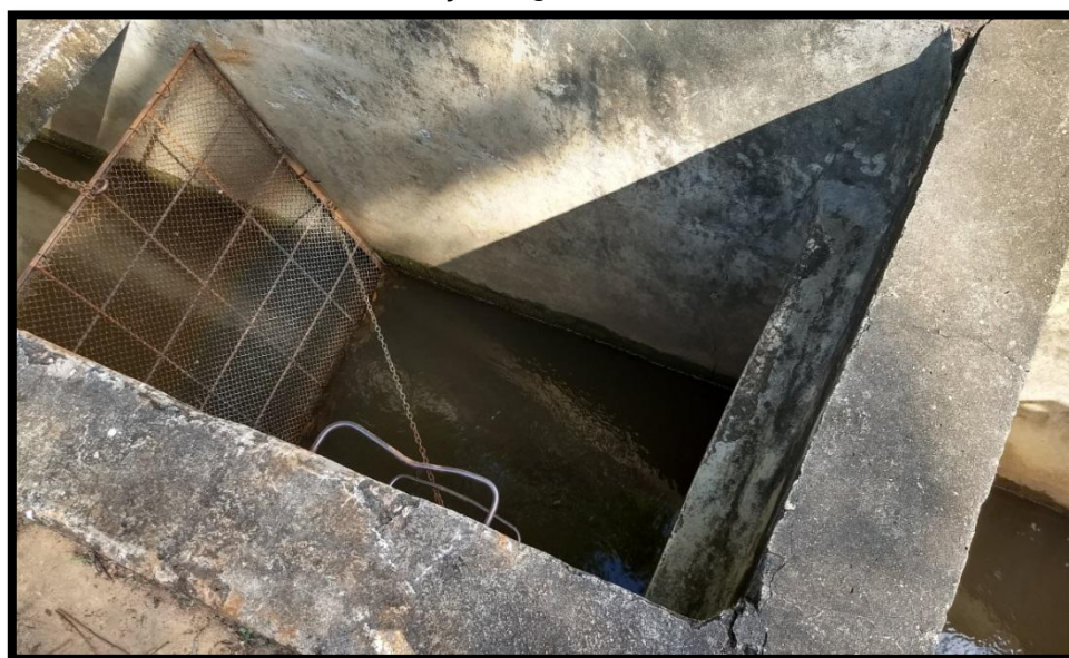
Foto 6.1.4 – Canal de adução e grade fina. Caixa de areia à direita.
