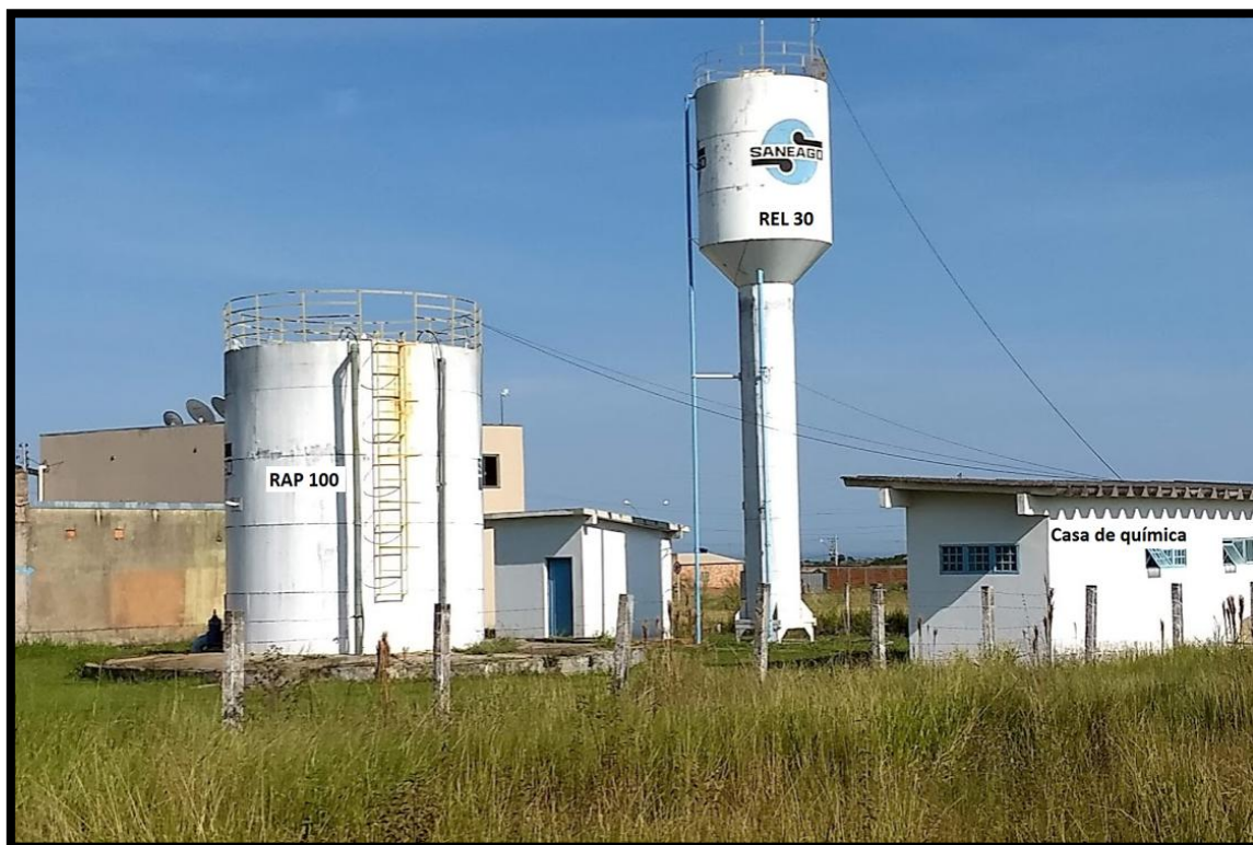
Foto 6.2.4 – RAP 100 m3, REL 30 m3 e Casa de química
