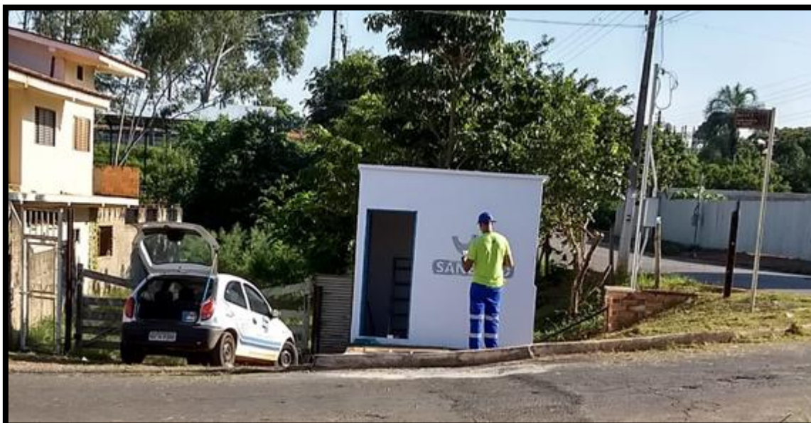
Foto 6.1.25 – Booster localizado no bairro Village Sul
