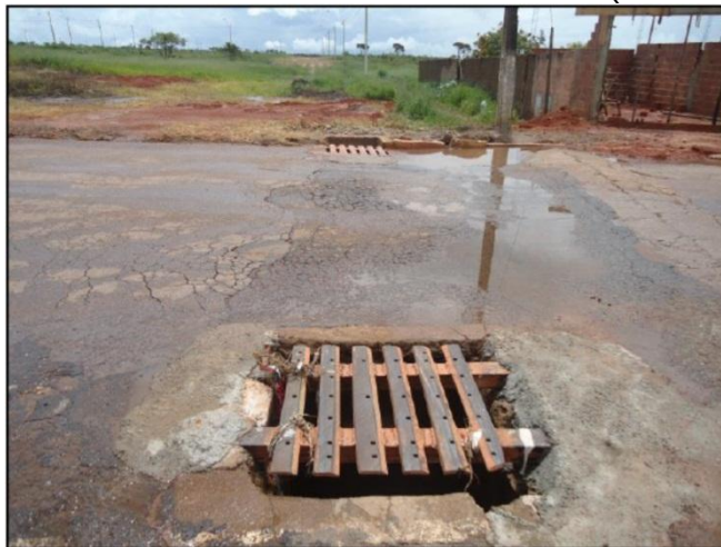
Foto 8.2.1 – Boca de lobo em Domiciano Ribeiro (Av. Paranaíba)
